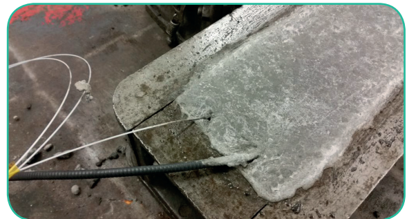
Fig. 5 - Cavo sensore T 130 GFRP-FBG su calcestruzzo per la connessione al dispositivo ottico di monitoraggio
