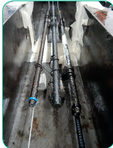
Fig. 4 - Cavo sensore T 130 GFRP-FBG legato alla barra di rinforzo prima di versare il calcestruzzo
